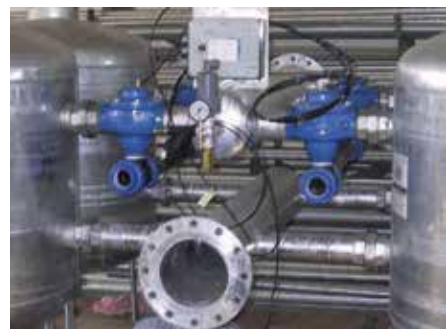
Automazione per filtri a quarzite
